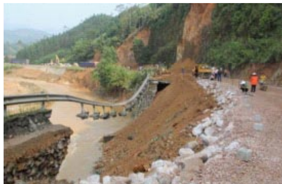
损毁严重的广西平武公路桂平段
