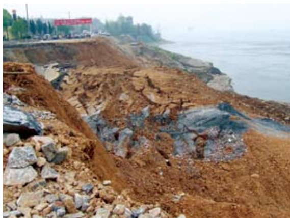
宜都河段洋溪崩岸
